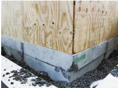
無対策実験 日立波で崩れた基礎
