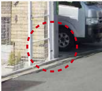
80cm沈下した電柱
