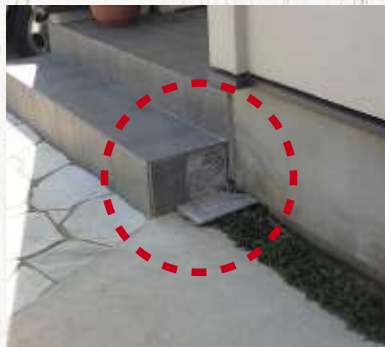
剥がれた玄関タイル
